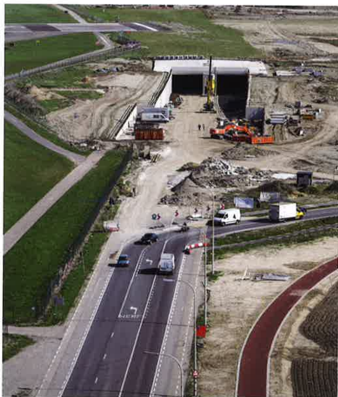
De lengte van het overdekte gedeelte, met aansluitend een af- en toerit in een open sleuf, bedraagt 420 meter.
